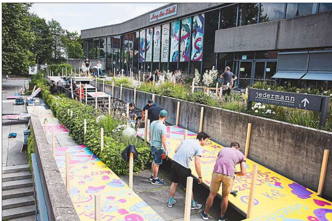
Für das Südwind-Festival haben elf Gruppen von Schulen über Jugendzentren bis hin zu Ausbildungsstätten einzelne Teile für eine große Rampe gefertigt. Am Donnerstag hat der Zusammenbau vor dem Stadttheater Ingolstadt begonnen. Foto: Schuktuew
